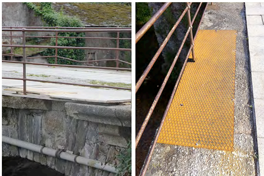
Foto 10. Esquerda, cornixa da ponte danada no transcurso das obras da Rúa da Igrexa. Dereita, chapa metálica “atornillada” á estrutura da ponte
